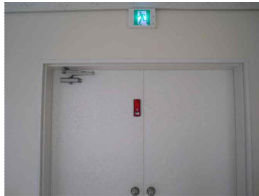
▲ 피난구 유도등이 올바르게 설치된 경우
