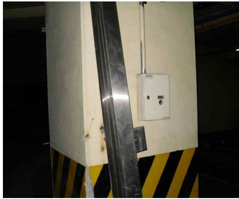
▲ 방화셔터 레일이 파손된 상태로 방치한 경우
