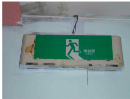
▲ 유도등이 부식되어 점등되지 않는 경우
