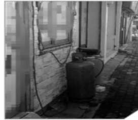
가스연결호수가 과도하게 길게 설치된 경우
