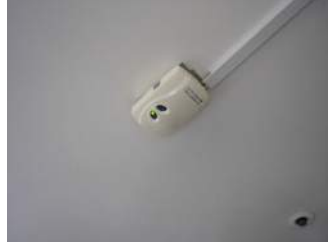
▲ 가스누설경보기의 탐지부가 설치된 사례
