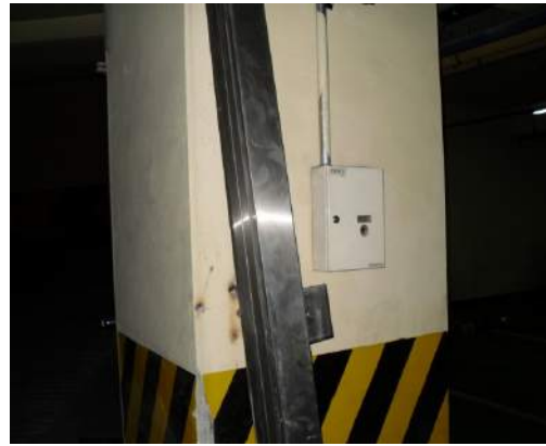
▲ 방화셔터 레일이 파손된 상태로 방치한 경우
