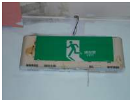
▲ 유도등이 부식되어 점등되지 않는 경우
