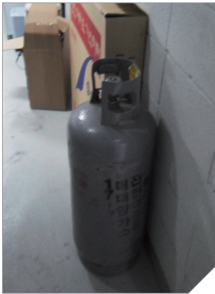
가스 저장용기 설치장소에 아무렇게나 방치
