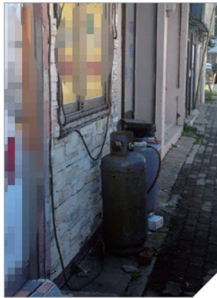
가스 연결호스가 과도하게 길게 설치된 경우
