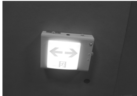
[통로유도등이 올바르게 설치된 경우]
