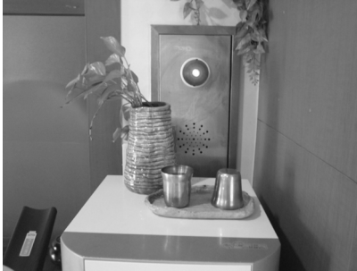
[적재물로 인하여 소방시설의 사용이 제한되는 경우]
