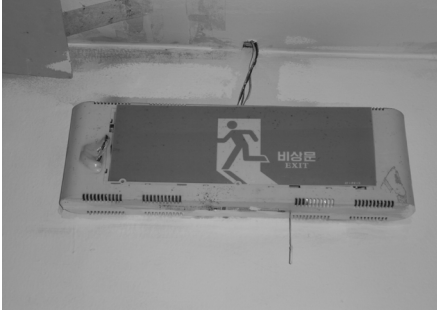
[유도등이 부식되어 점등되지 않는 경우]
