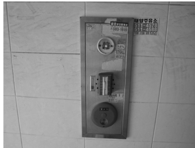
[위치표시등의 파손을 방지한 경우]
