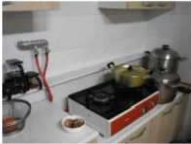
가스누설경보기가 미설치된 경우
