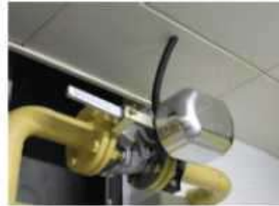
가스누설경보기의 차단밸브가 설치된 사례
