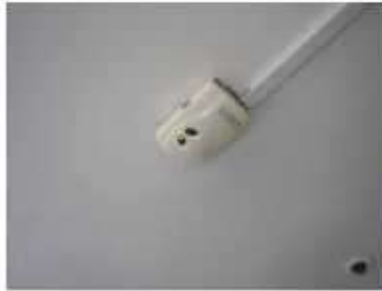
가스누설경보기의 탐지부가 설치된 사례
