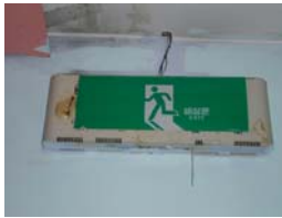
▲ 유도등이 부식되어 점등되지 않는 경우
