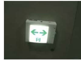
▲ 통로유도등이 올바르게 설치된 경우
