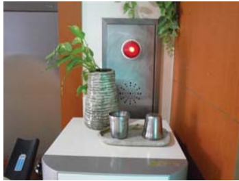
▲ 적재물로 인하여 소방시설의 사용이 제한되는 경우
