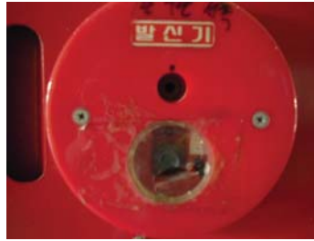
▲ 발신기의 파손을 방치한 경우
