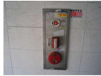
▲ 위치표시등의 파손을 방치한 경우
