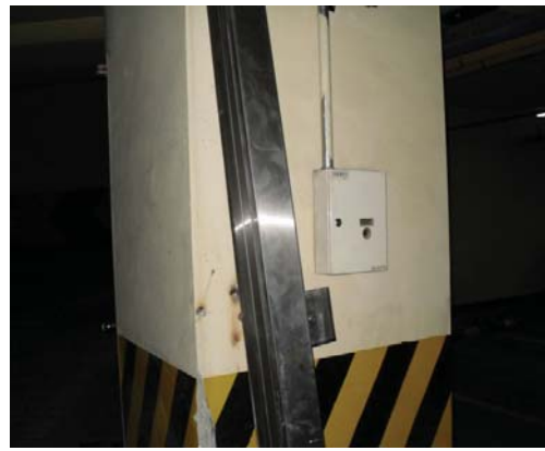
▲ 방화셔터 레일이 파손된 상태로 방치한 경우
