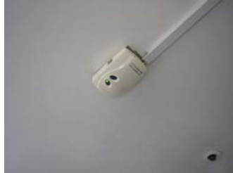
▲ 가스누설경보기의 탐지부가 설치된 사례
