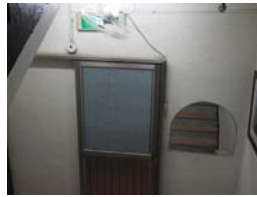
▲ 장애물로 인한 유도등의 식별이 제한되는 경우
