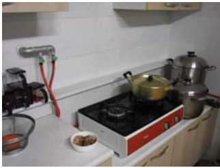
▲ 가스누설경보기가 미설치된 경우
