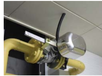
▲ 가스누설경보기의 차단밸브가 설치된 사례
