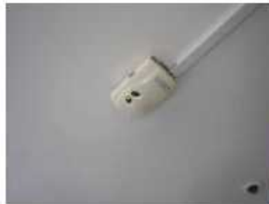
가스누설경보기의 탐지부가 설치된 사례
