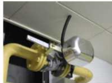
가스누설경보기의 차단밸브가 설치된 사례
