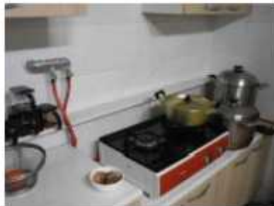
가스누설경보기가 미설치된 경우
