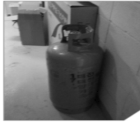
가스저장용기 설치장소에 아무렇게나 방치
