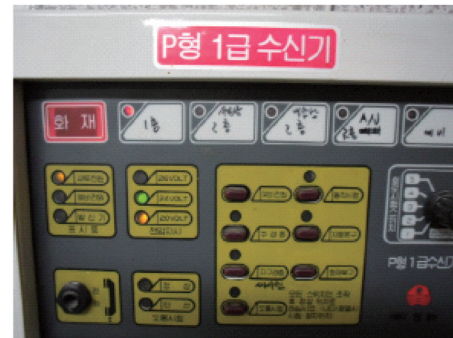
▲ 화재 오동작시 복구하지 않고 방치한 경우
