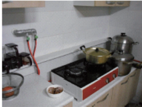
▲ 가스누설경보기가 미설치된 경우
