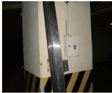
▲ 방화셔터 레일이 파손된 상태로 방치한 경우
