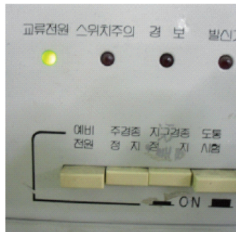
▲ 수신기 정지버튼을 누른 상태로 방치한 경우
