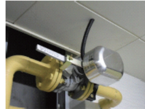
▲ 가스누설경보기의 차단밸브가 설치된 사례
