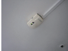
▲ 가스누설경보기의 탐지부가 설치된 사례
